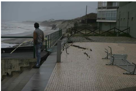
Figura 8: Danos verificados no passeio que separa as torres da praia.
